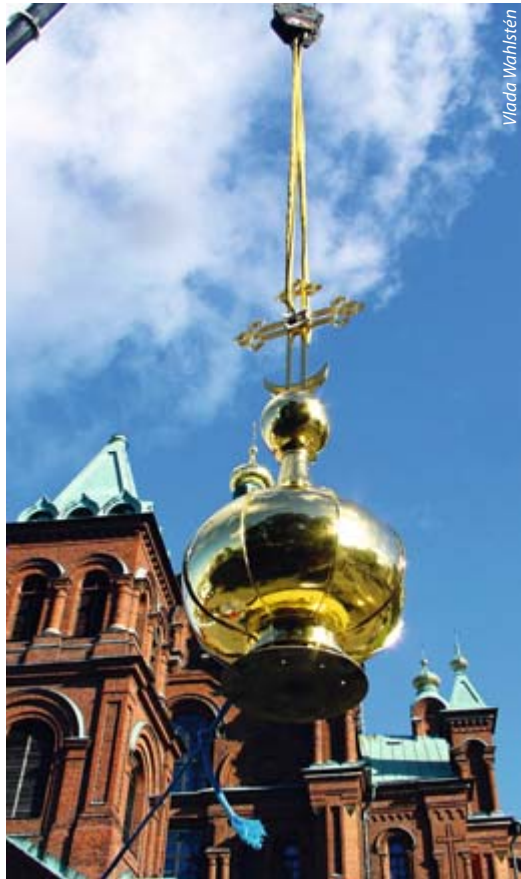
1900-luvun alkupuolella suomalaistuttamisen nimissä haluttiin päästä eroon kupoleista ja punatiilestä. Uspenskin katedraali on säilynyt alkuperäisessä asussaan. Kuva kupolien korjauksesta vuodelta 2005.
