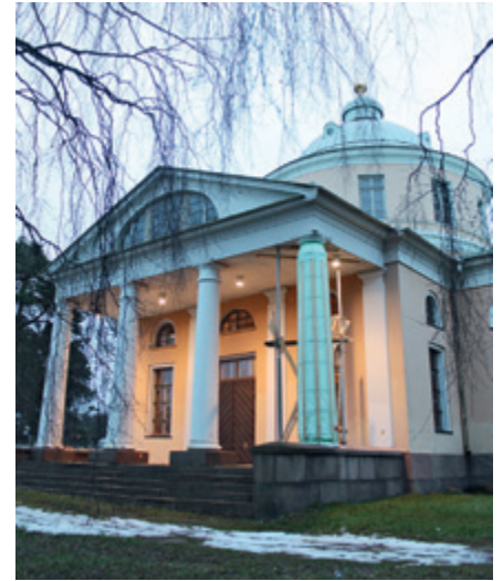
Kotkan kirkko kaipaa korjausta ja odottaa aitaa ympärilleen.
